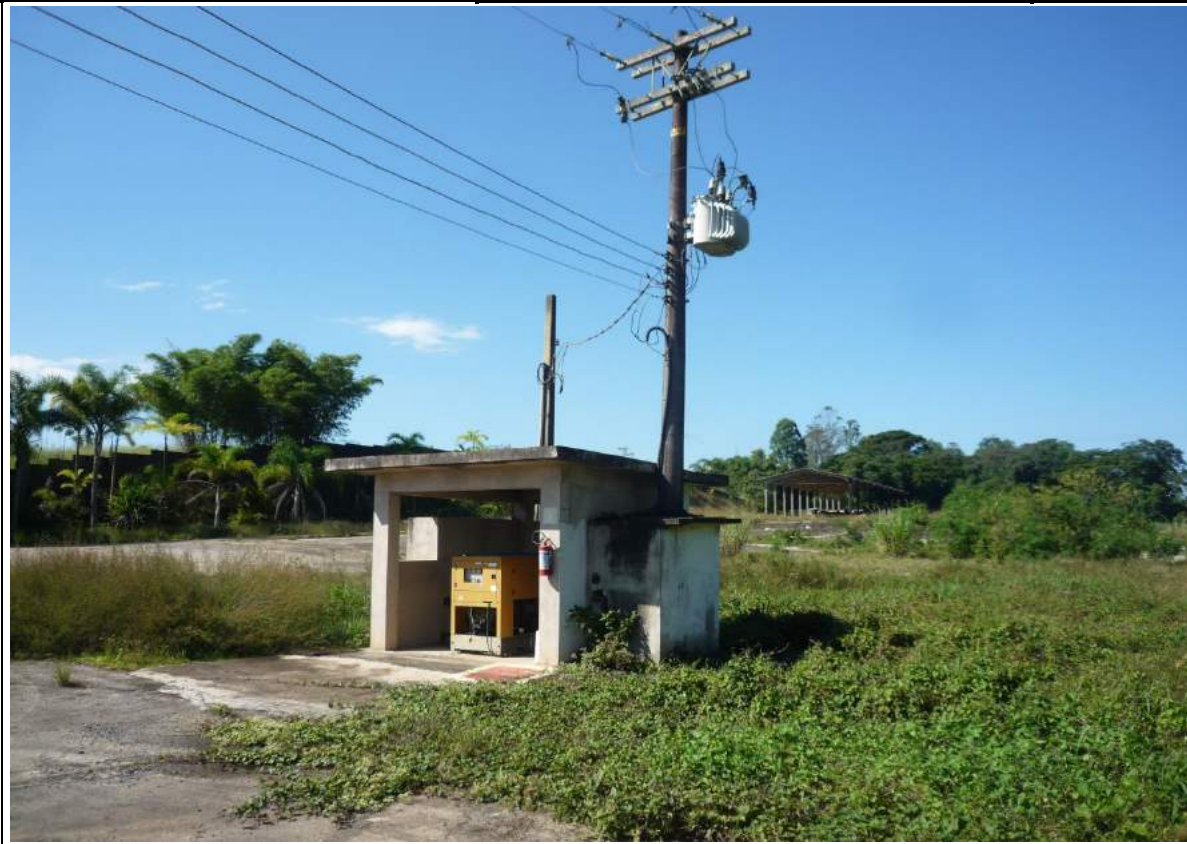
FOTO 11= ENTRADA DE ENERGIA ELÉTRICA E E GERADOR
