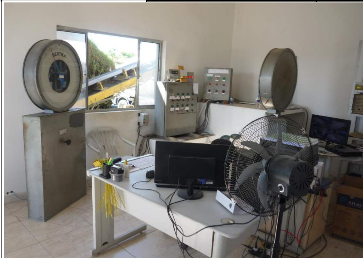
FOTO 15= VISTA INTERNA DA BALANÇA DE USINAGEM DO CONCRETO
